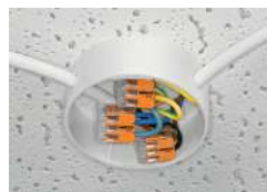
Distribution d'éclairage dans les plafonniers
